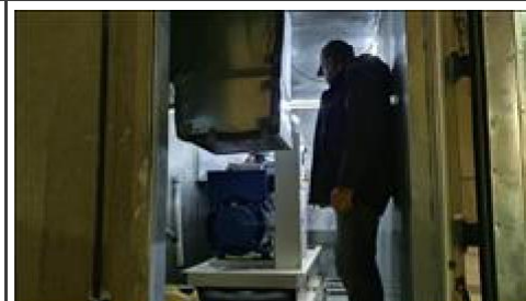
Генератор для увеличения мощности электричества в театре Института по адресу г. Москва, ул. Ботаническая. 21
